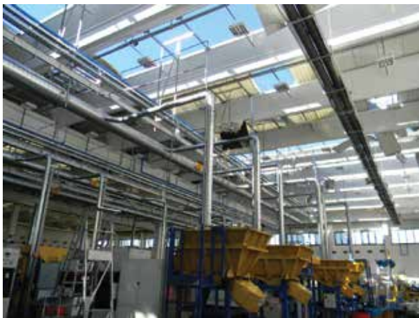
Interno della Agrati dopo la tromba d'aria
