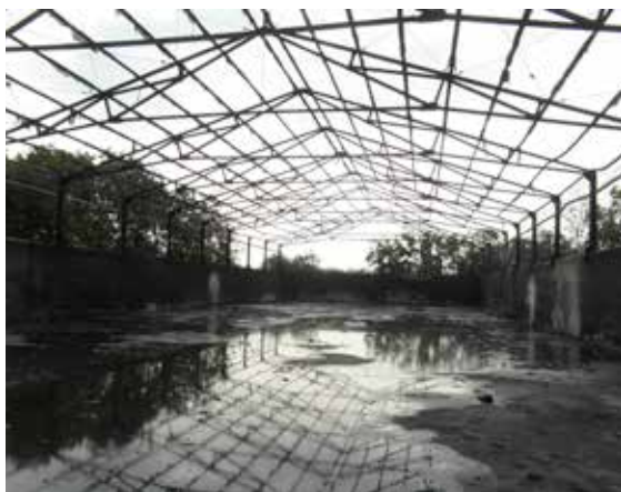
Il sito produttivo in cui si è sviluppato l'incendio
