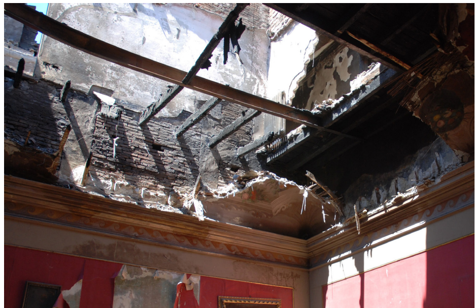
Un esempio tipico di stratificazione strutturale nel tempo: è di tutta evidenza che in un palazzo con impianto cinquecentesco non potevano esservi all'origine strutture di interpiano in carpenteria metallica. Immediatamente percepibile la divisione di un unico piano nobile, originariamente realizzato, in più livelli abitativi. A sorpresa, l'incendio e i crolli hanno svelato l'esistenza di affreschi storici importanti, di cui si era persa memoria.
